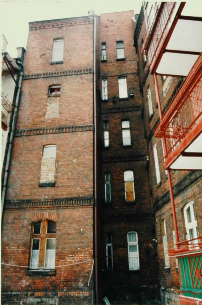
Zdj.5. Widok na zamurowane okna sanitariatów
