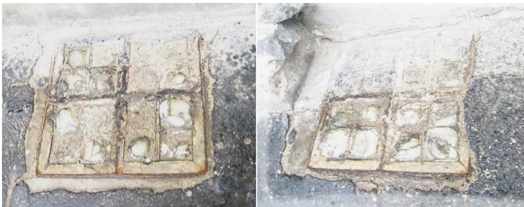
Fot. 6. Zamurowane świetliki spod kamienicy Autor: Adrianna Kula
